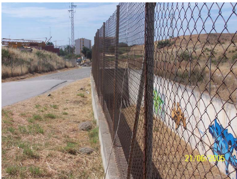
Tramo del Norte del vial sin ejecutar junto a la trampa de acarreos del embovedado del Arroyo Juan Benítez
