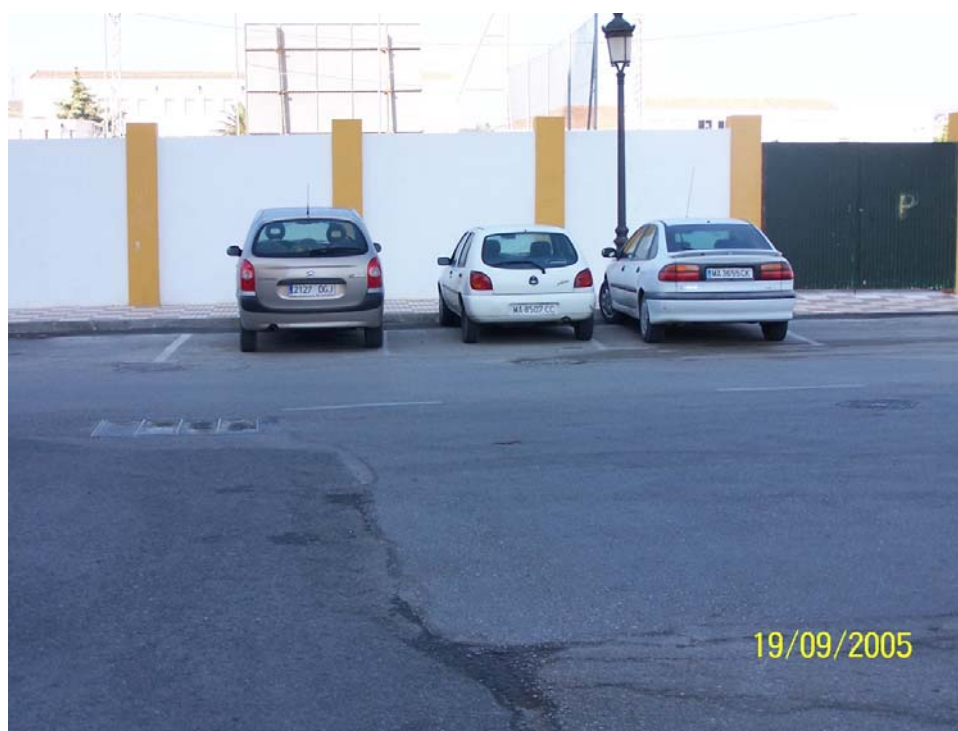
Aparcamientos existentes en el campo de fútbol. Arqueta Telefónica tipo H a reparar
