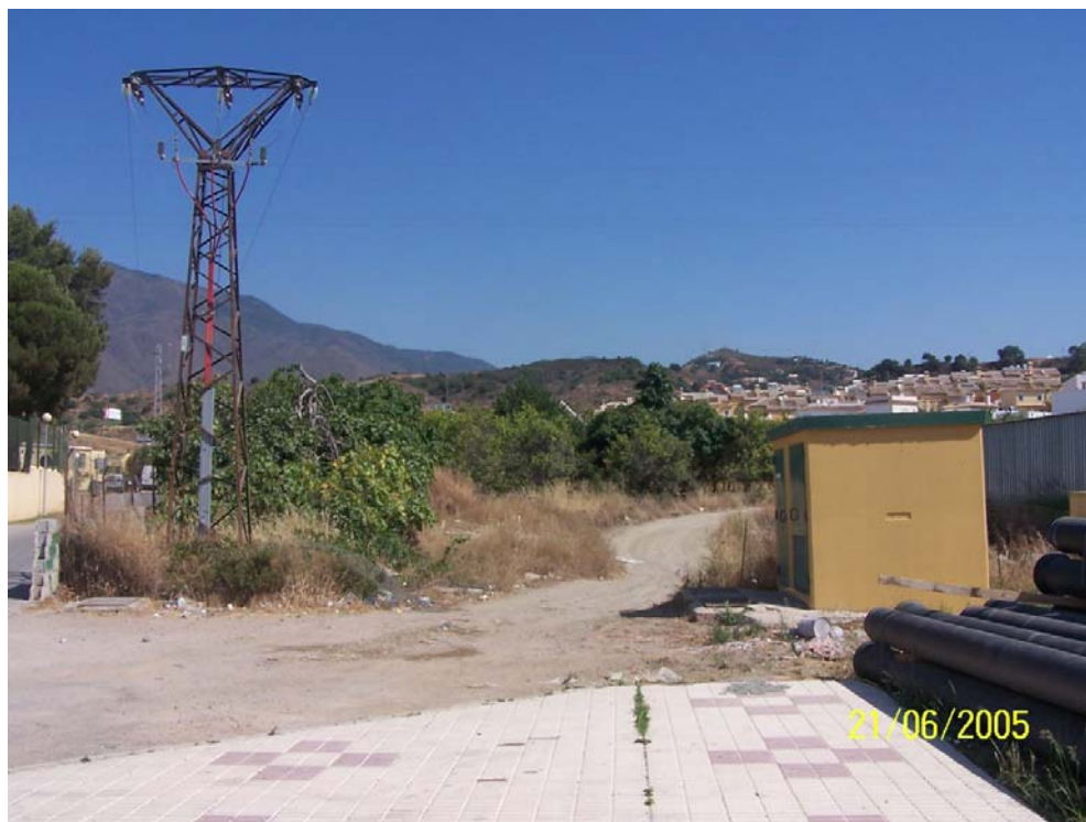
Depósito junto a centro de transformación nº66674 y uno de los apoyos.
