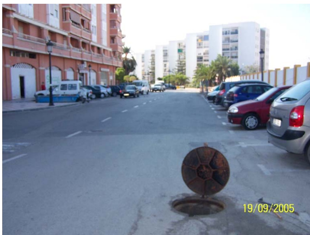
Colector a sellar de saneamiento que vierte directamente al embovedado del Arroyo Juan Benítez
