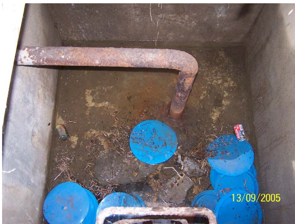
Interior de arqueta
